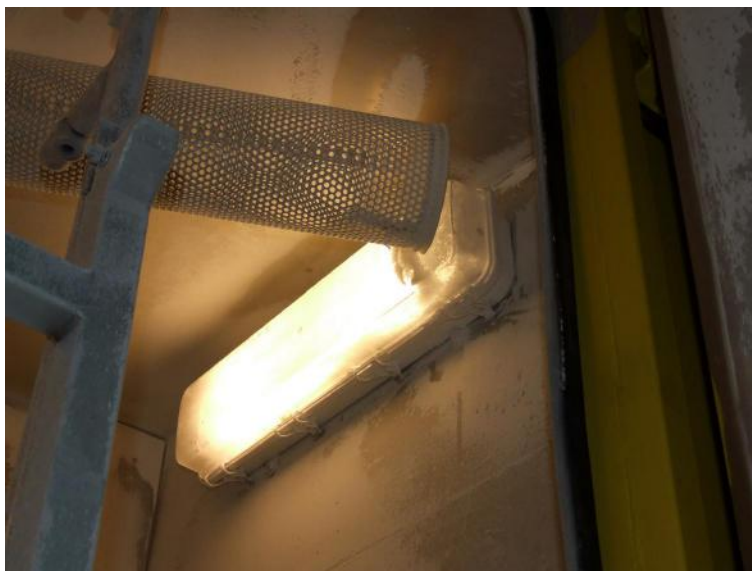
Fot. 1 Oprawa oświetleniowa w komorze pyłowej
